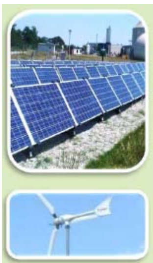
GENERACIÓ PV 28kWp GENERACIÓ WT 3.5kW
